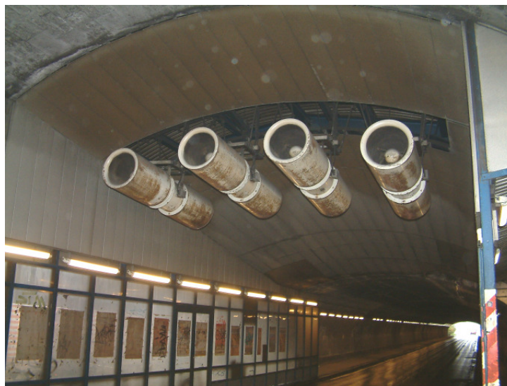
Abb. 2: Einhausung der Strecke zwischen den Gleisunterführungen und Detail Strahlventilatoren.
